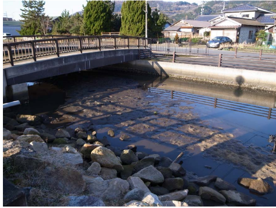
【図 38：汚泥の露出した水路と柵】
