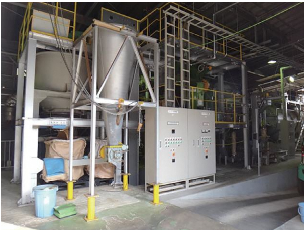
設備が一新された工場内
