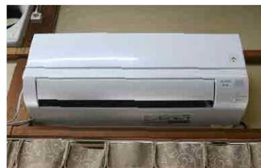
エアコン (亀山公民館)
