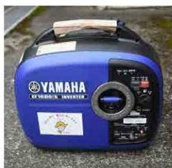
発電機 (上地公民館)
