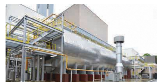
クリーンセンター内に設置してあるメタン発酵槽
